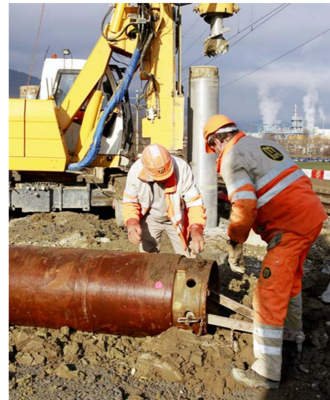
Afin d'assurer la stabilité de la ligne CFF, des pieux en béton ont été installés tous les 3,5 mètres, le long de la décharge.
