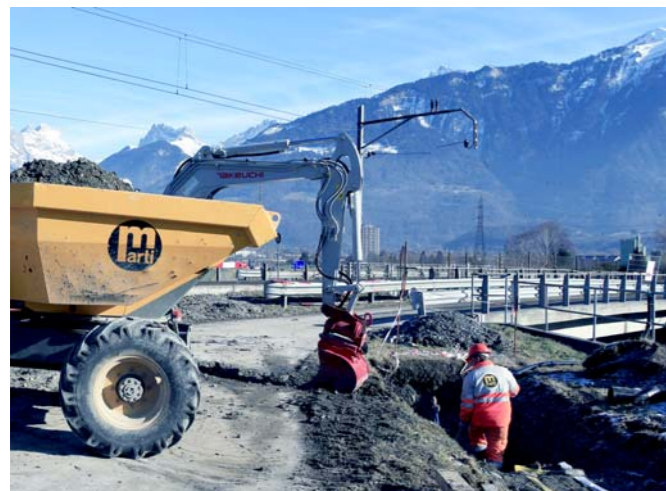
Avant de débiter les travaux d'assainissement, le déplacement de nombreuses conduites souterraines a été nécessaire (fibres optiques, électricité, etc.).
