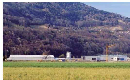
Deux halles ont été construites pour le chantier d'excavation de la décharge. La plus grande est déplacée au fur et à mesure des travaux. La seconde (à gauche sur la photo) a été utilisée pour l'assainissement du secteur Est (voir plan).
